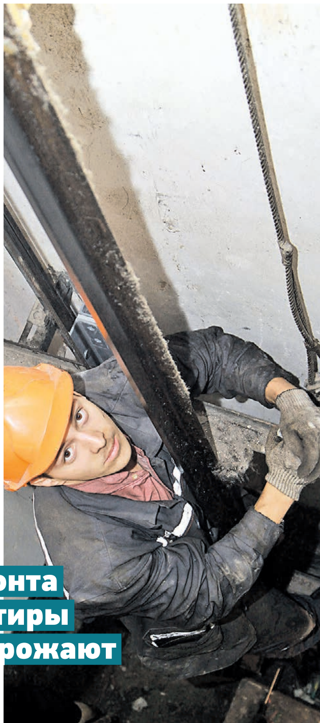
15 сентября 2015 года. Механик Виктор Зотов демontiрует оборудование в лифтовой шахте на улице Арбат, 45
