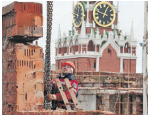
2 февраля 2016 года. Рабочий разбирает конструкции 14-го корпуса Кремля. Открыт вид на Спасскую башню
