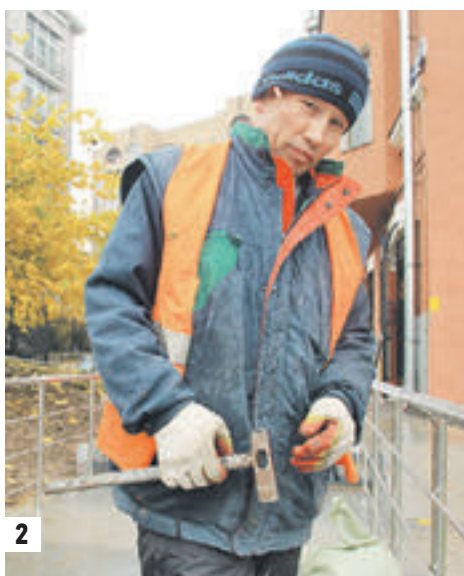
17 октября 2017 года. Москвич Василий Иванович спускается на Олимпийский проспект по лестнице (1). Рабочий Ширали Мамедов устанавливает перила на новой лестнице (2)
