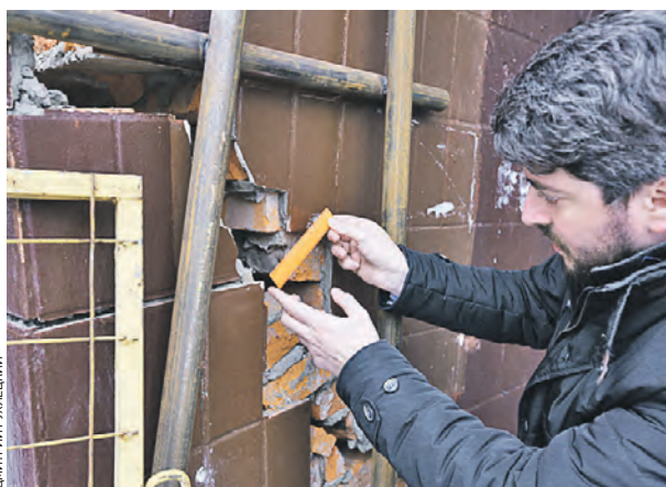
Дом № 9 по улице Марксистская можно отнести к разряду аварийных — здесь частично обрушилась стена
