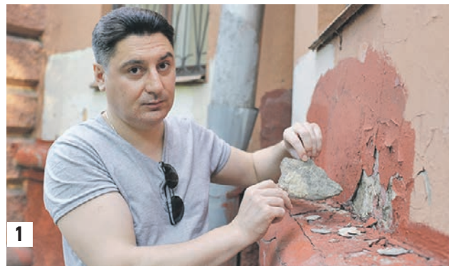
7 августа 2015 года. Председатель совета многоквартирного дома № 3 по 3-й Фрунзенской улице Максим Журавлев демонстрирует: дом явно нуждается в капитальном ремонте (1) Крышу тоже заменят (2)
