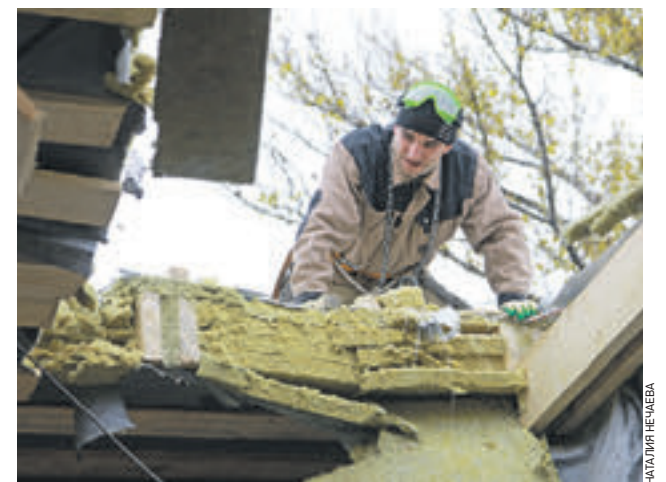
4 ноября 2015 года. На Покровке, 23, рабочие Борис Юрчишин и его коллеги демантируют незаконно построенную мансарду
