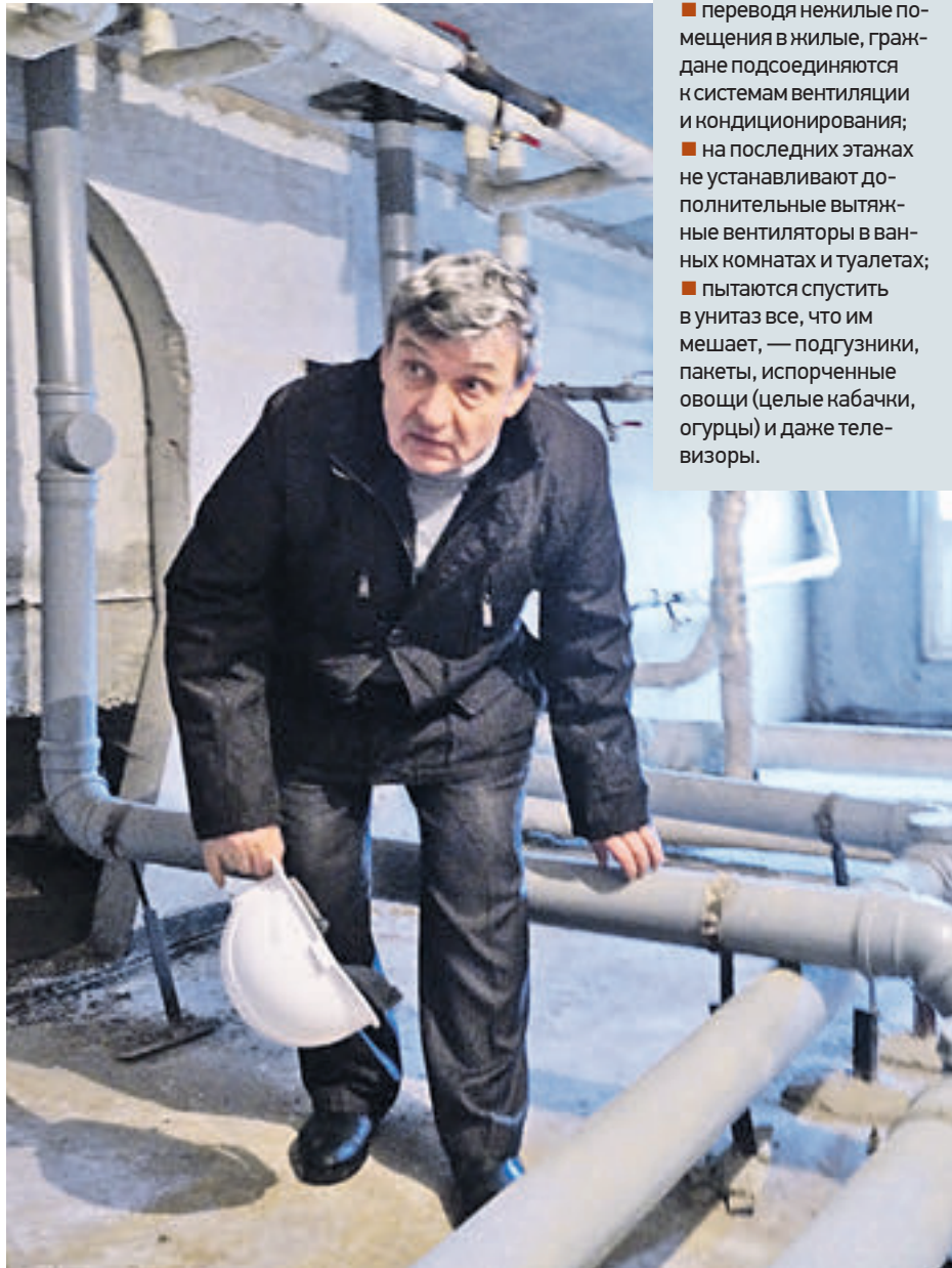
Бригада «МЦ» установила, что канализационная система в доме работает отлично. Причина неприятного запаха в квартирах многоэтажки — неаккуратное использование сантехники жителями
