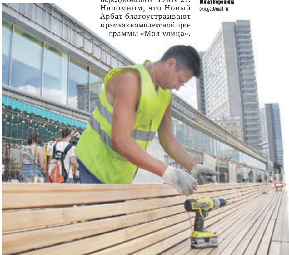
10 августа 2016 года. Алексей Шамин завершает финальные работы по монтажу самой длинной городской скамейки на улице Новый Арбат. Протяженность этого объекта достигает 300 метров
