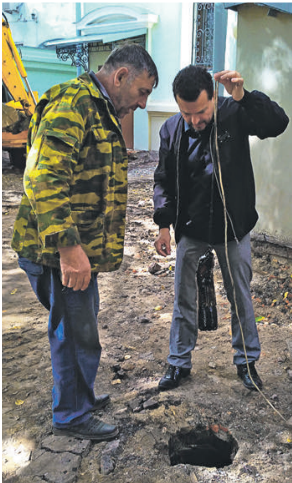
2 сентября 2016 года. Муниципальный депутат Тверского района Сергей Дугин (справа) проверяет глубину обнаруженного нефтехранилища вместе с прорабом подрядной организации
