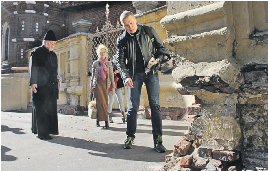
3 октября 2016 года. Муниципальный депутат Алексей Бондаренко и отец Александр осматривают обвалившийся забор
