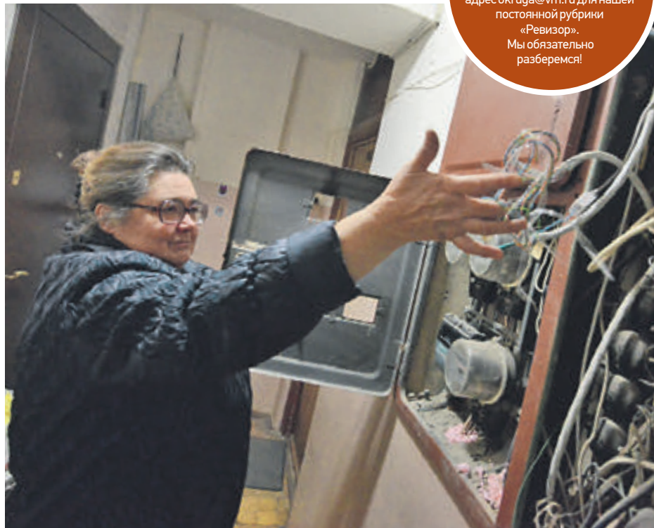
22 октября 2016 года. Трифоновская улица. Жительница дома № 61, корпус 2 Анастасия Николаева показывает, как рабочие во время капремонта некачественно подсоединили провода в щитке
