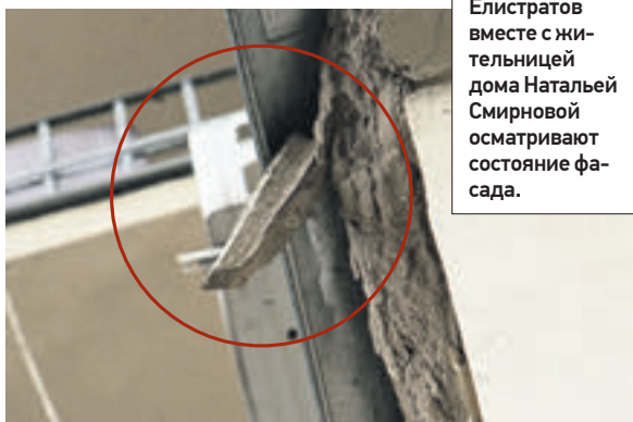
Отваливающиеся куски штукатурки от дома № 32–34 по Космодамианской набережной.
