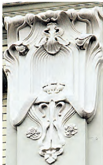
Четырехэтажное здание, возведенное в начале прошлого века на участке по адресу: Арбат, 23, соединило в своем оформлении черты австрийского, бельгийского и французского стиля ар-нуво, так популярного в те годы.
