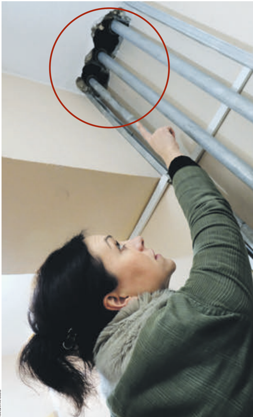
16 ноября 2017 года. Жительница дома № 3/13 по улице Дурова Дарья Хмельницкая надеется, что во время ремонта подъездов рабочие заштукатурят дыры в потолке
