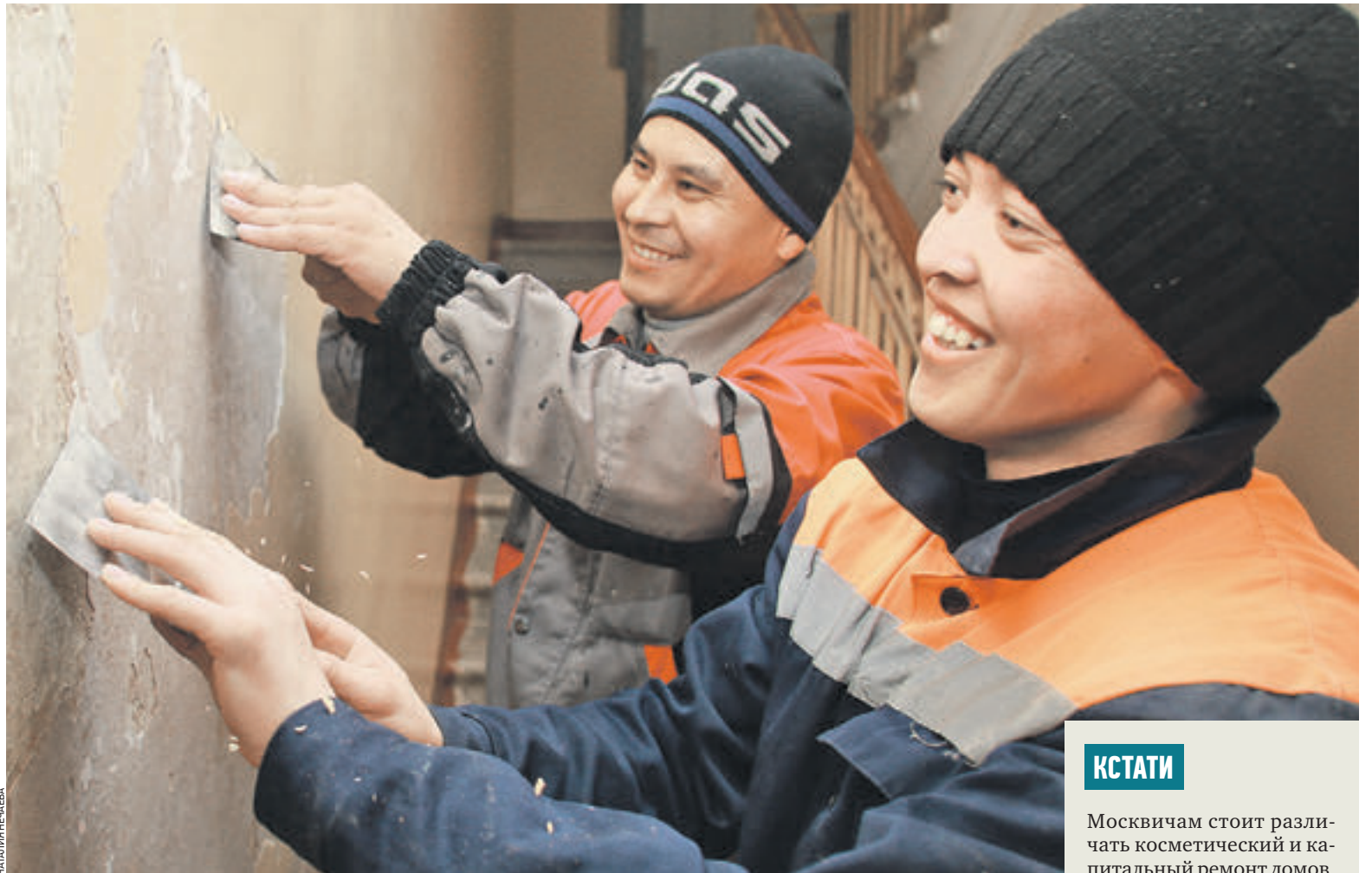
2 апреля 2018 года. Сотрудники ГБУ «Жилищник района Арбат» Шамурза уулу Тыныбек (на первом плане справа) и Туратбек уулу Бактыбек (слева) приступили к ремонту — рабочие очищают стены подъезда от старой масляной краски
