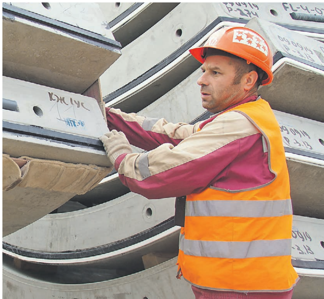
14 сентября 2019 года. Проходчик Владимир Кархагин крепит стропы и тубингу на площадке строящейся станции БКЛ «Стромынка»
