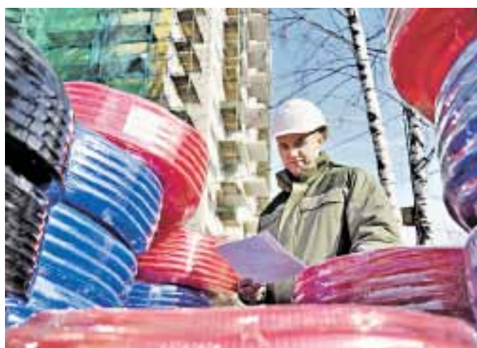
26 марта 2019 года. Начальник участка Сергей Васильев следит за отгрузкой материалов для строительства дома
