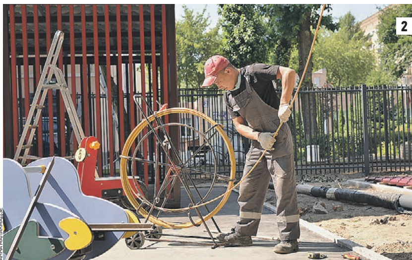
На территории детского сада появятся тенистые навесы, велопарковка, площадка для изучения Правил дорожного движения (1). Игровые элементы уже устанавливают (2)
