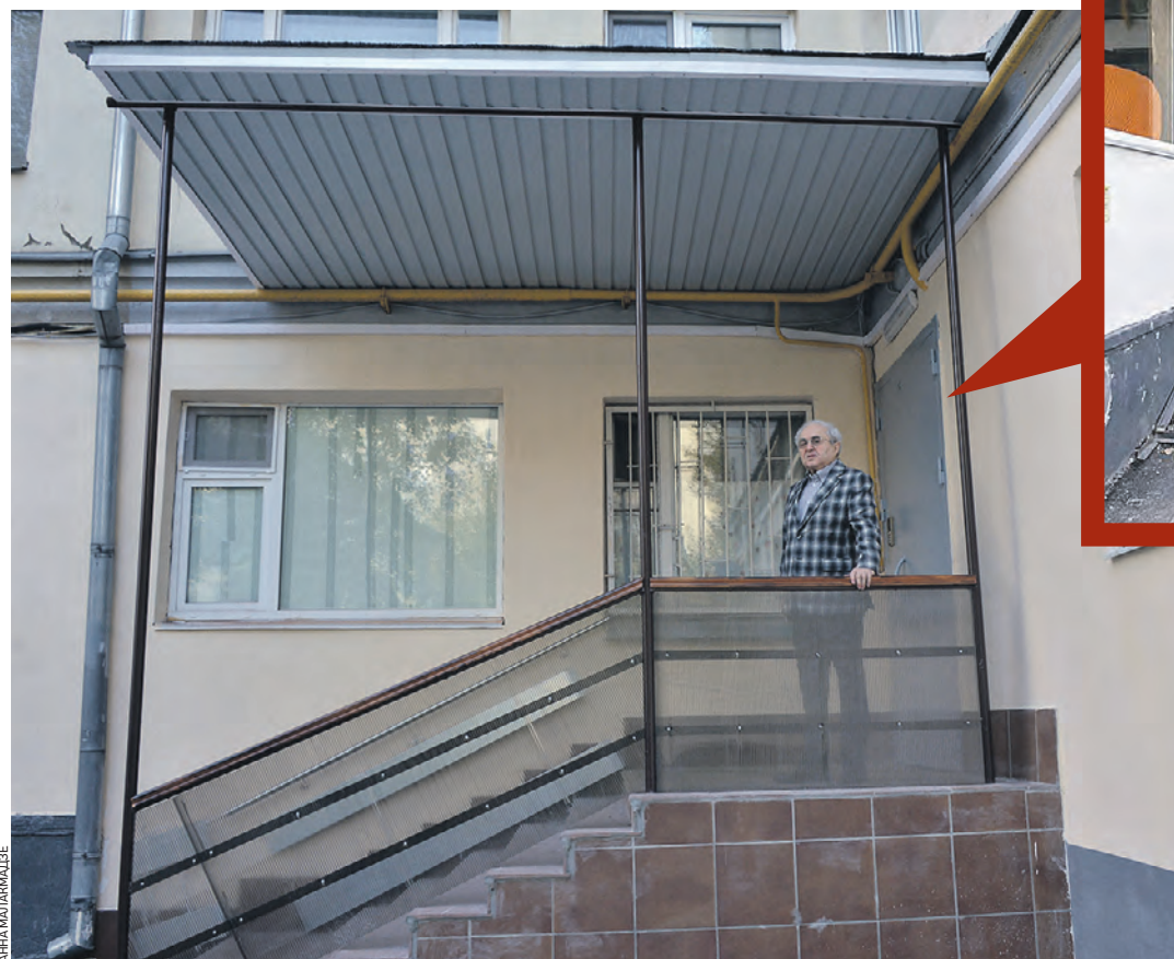
4 октября 2021 года. Житель Таганского района Макар Сафаров показывает, как сотрудники «Жилищника» отремонтировали козырек и ступени подъезда, которые были разрушены от дождей
