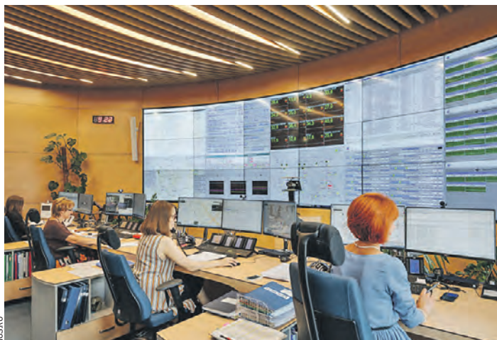
Так выглядит Центральное диспетчерское управление АО «Мосводоканал». Здесь специалисты следят за чистотой воды
