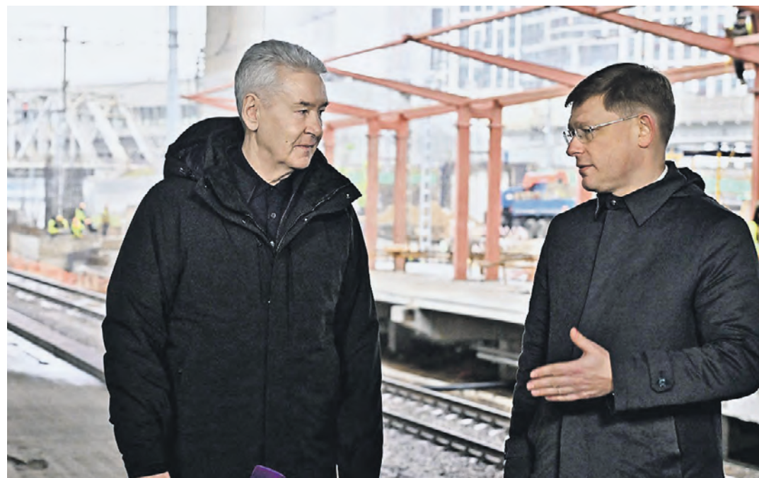
21 ноября. Мэр Москвы Сергей Собянин (слева) и заместитель генерального директора РЖД Андрей Макаров обсудили сроки строительства городского вокзала «Москва-Сити»
